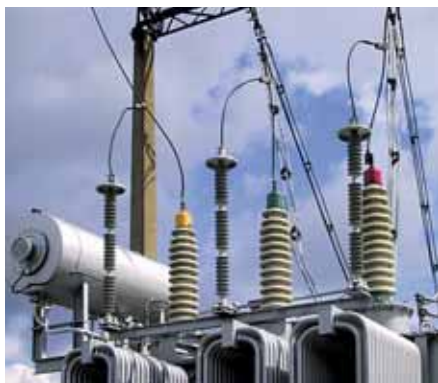
ОПН 110 кВ (Эстония)
